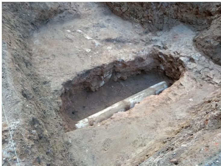
Foto 113.18.16, vista de la rasa del clavegueró excavada i de la claveguera del carrer del Comerç i l'anivellació UE 18.
